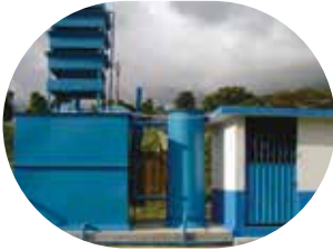
Planta de tratamiento de agua
